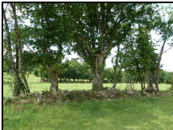
Photographie 3 : Talus de pierres dégradé (échantillon de Crac'h, Juillet 2011)
